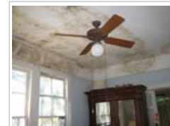
Feuchtigkeit fördert die Entwicklung von Schimmelpilzen.
