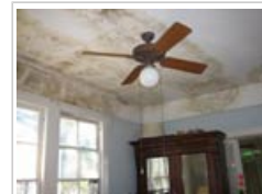
Feuchtigkeit fördert die Entwicklung von Schimmelpilzen.
