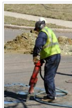
Se han establecido límites para proteger a los trabajadores de la exposición excesiva al ruido Source : Shutterstock
