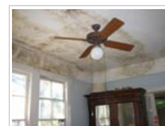
L'humidité favorise la prolifération de moisissures
