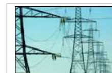
Voir aussi notre publication sur les lignes électriques [voir https://www.greenfacts.org/fr/lignes-electriques/index.htm ]
